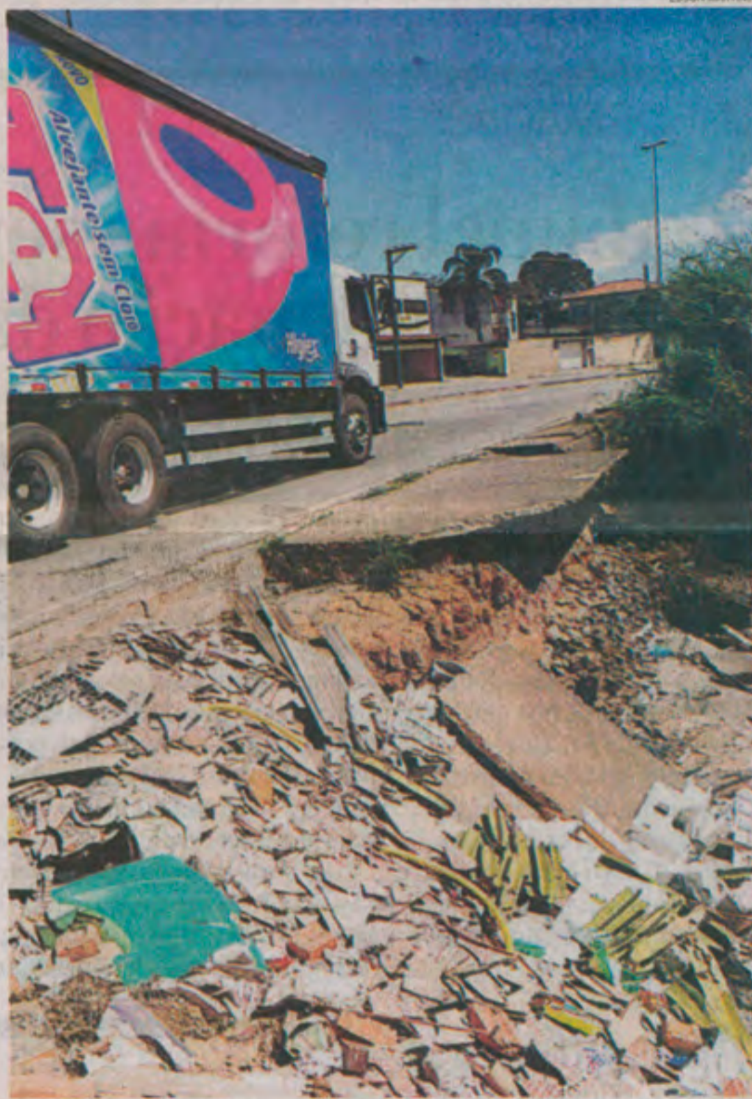
SEM ACOSTAMENTO Buraco avança em pista da Miguel Gemma
